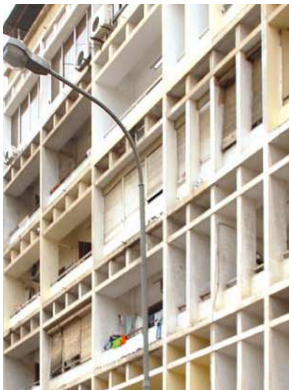
{ FIG. 3.16 } Utilização de palas fixas verticais e horizontais de sombreamento, num edifício modernista em Luanda.
