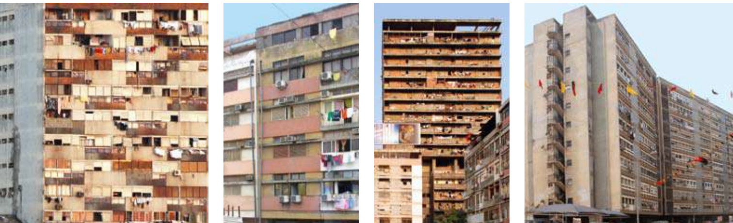
{ FIG. 1.3 } Exemplos de edifícios a necessitar de reabilitação, em Luanda.
