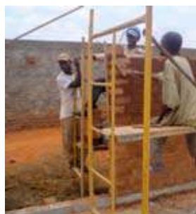
{ FIG. 7.5 } Construção de parede com BTC no centro do Bairro Palanca, dirigido pelo arquitecto Argentino Maurício Banguilia.
