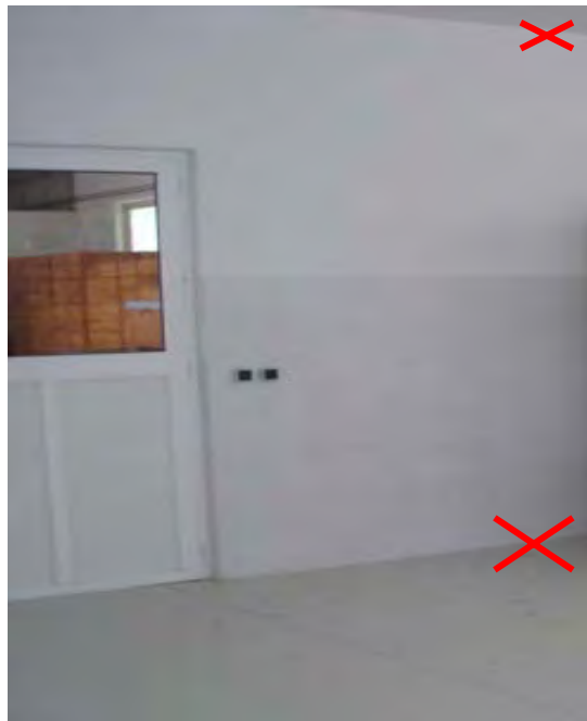
FIGURA 8 – Aspectos estruturais da unidade da produção primária de mel: as esquinas, ângulos e uniões entre paredes, entre paredes e pavimento e entre paredes e tecto devem ser arredondados (X assinala a ausência de perfil sanitário).
