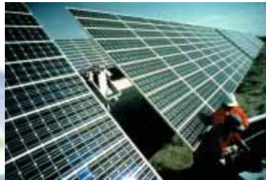
Figura 2.18 - Sistema fotovoltaico com ligação à rede, encontrando-se a instalação fixada no solo Imagem: Siemens
