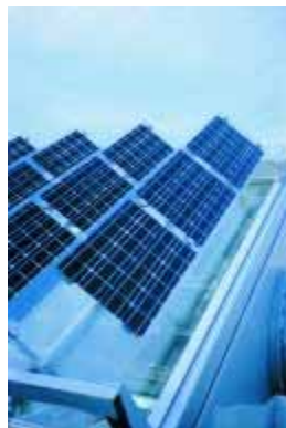
Figura 3.33 - Módulos semitransparentes para protecção solar no telhado em forma de dente de serra de uma casa particular (Jakob-Kaiser-Haus) em Berlim, Alemanha
