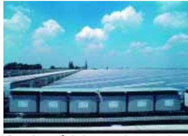
Figura 5.8 - Inversores de fileira de módulos ao longo do sistema fotovoltaico de Herne Fotografia: Flabeg
