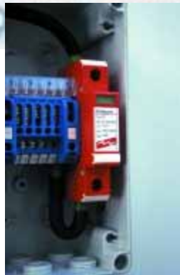
Figura 5.27 - Descarregador de sobretensões
