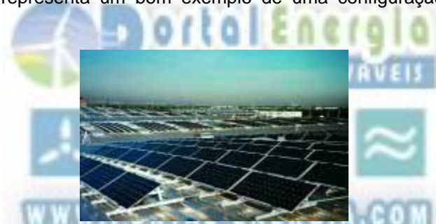
Figura 5.5 - Sistema fotovoltaico de 1 MWp do Centro de Exibições Neue Messe München , em Munique
