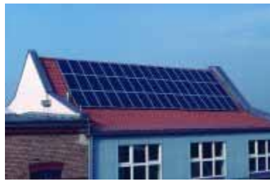
Figura 2.17 – Sistema fotovoltaico com ligação à rede numa área urbana, na zona comercial de Weiberwirtschaft em Berlin
