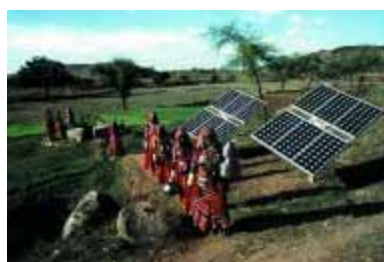
Figura 2.13 – Sistema solar de bombagem de água para garantir o fornecimento de água potável Imagem: Fa. Siemens
