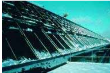
Figura 4.2 - Neve num sistema fotovoltaico Fotografia – Energiebiss
