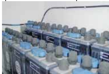
Figura 3.113 - Sistema de acumulação de Mindelheimer Hütte (nos Alpes). O nível do electrólito é facilmente verificado pelas marcas na caixa transparente da bateria
