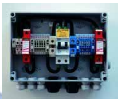
Figura 3.78 - Caixa de junção do gerador
