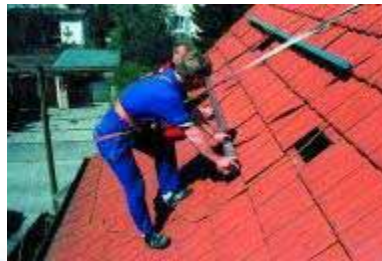
Figura 9.3 – Equipamento individual de protecção
