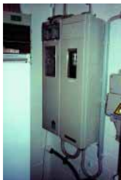
Figura 9.20 – Caixa do contador
