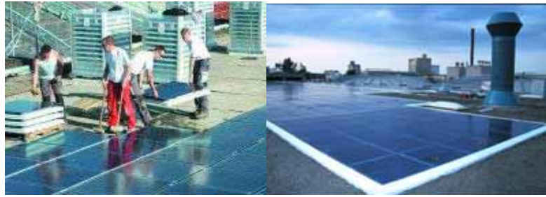
Figura 8.136 - Telhado plano Powerguard Fotografias: Powerlight GmbH
