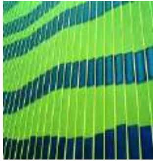
Figura 8.87 - 50 kW p Solartec sobre estrutura ondulada na fachada industrial no ThyssenKrupp Stahl em Duisburg-Beeckerwerth, na Alemanha
