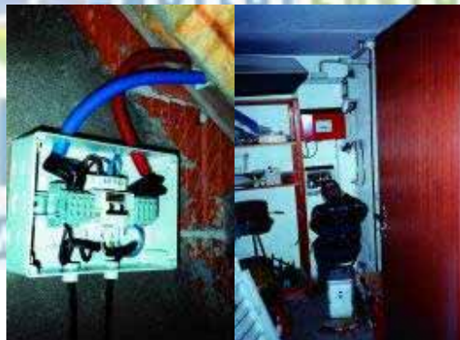
Figura 9.19 – Esquerda: Caixa de junção geral do gerador e Direita: Instalação dos inversores
