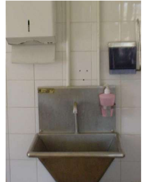
Lavatório de comando não manual
