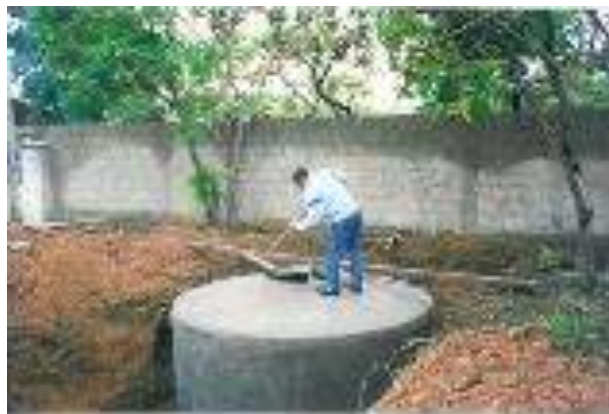
ILUSTRAÇÃO 12: RESERVATÓRIO PARA CAPTAÇÃO
