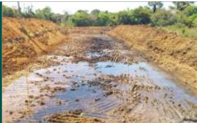
FIGURA 14 - Construção sem investigação do solo, em terreno com lençol freático raso
